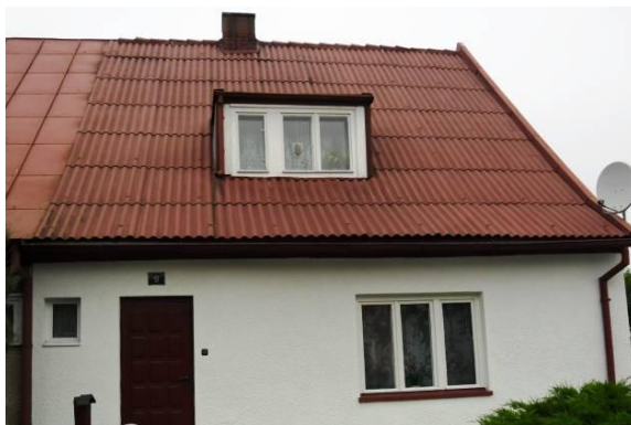
Rys. 6. Pokrycie dachowe ocenione w III stopniu pilności.
