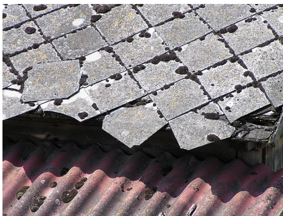
Rys. 8. Pokrycie dachowe ocenione w I stopniu pilności.
