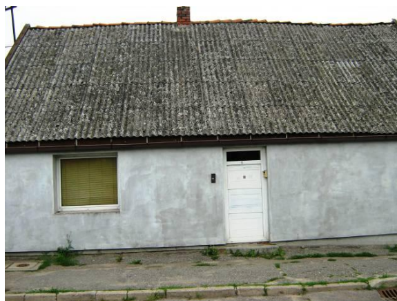
Rys. 7. Pokrycie dachowe ocenione w II stopniu pilności.
